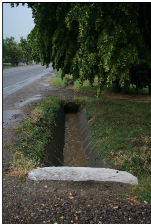
Abbildung 10: Entwässerungsrinne an einer Hauptstraße
