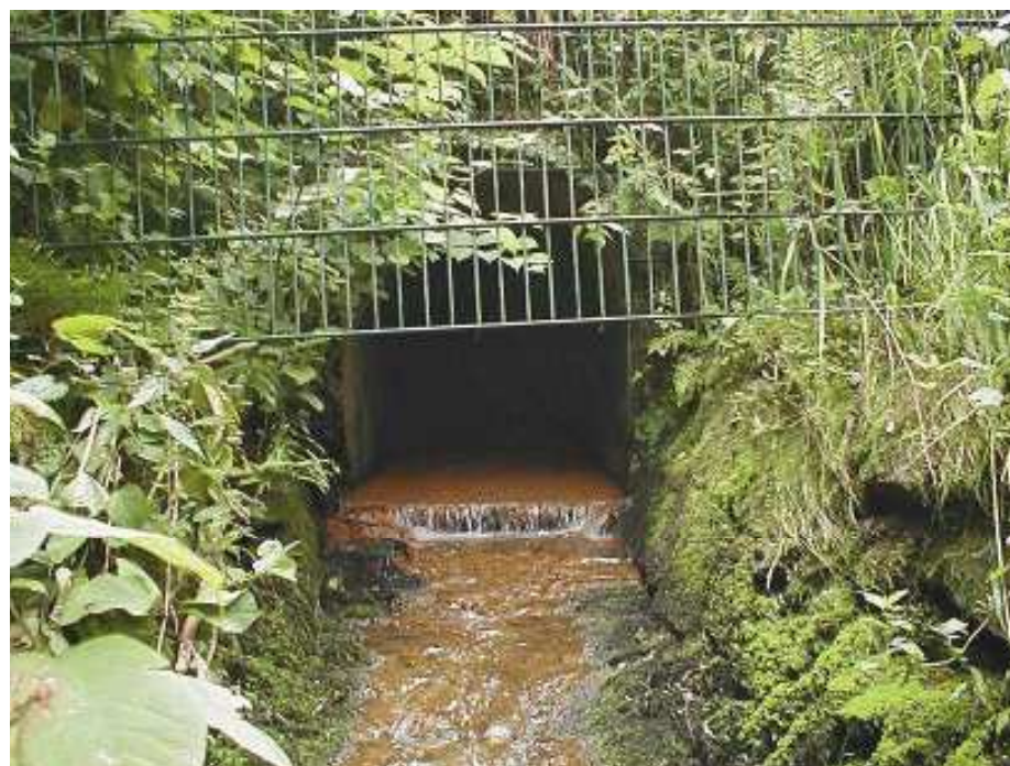
Abb. 1: Austritt des kanalisierten Müggenbaches in den offenen Bereich
